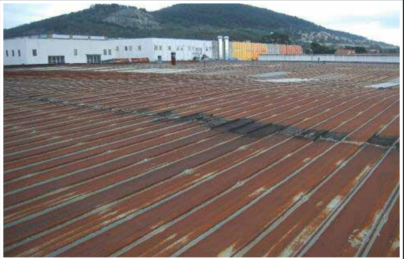
Condiciones de la cubierta metálica de casi 7.000 m 2 antes de las operaciones de restablecimiento
